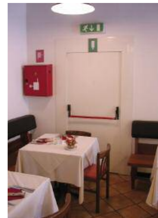
Esempio di situazione riscontrabile: uscita di sicurezza ostruita
